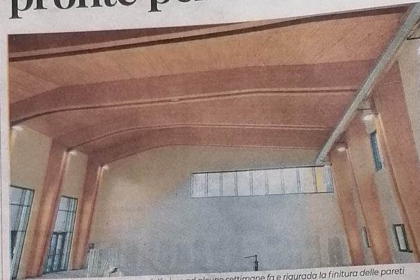
Interno della palestra. L'immagine si riferisce ad alcune settimane fa e riguarda la finitura delle pareti
