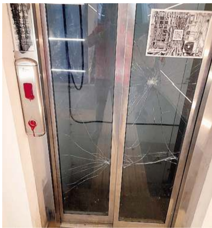
L'ascensore è guasto e con i vetri rotti
