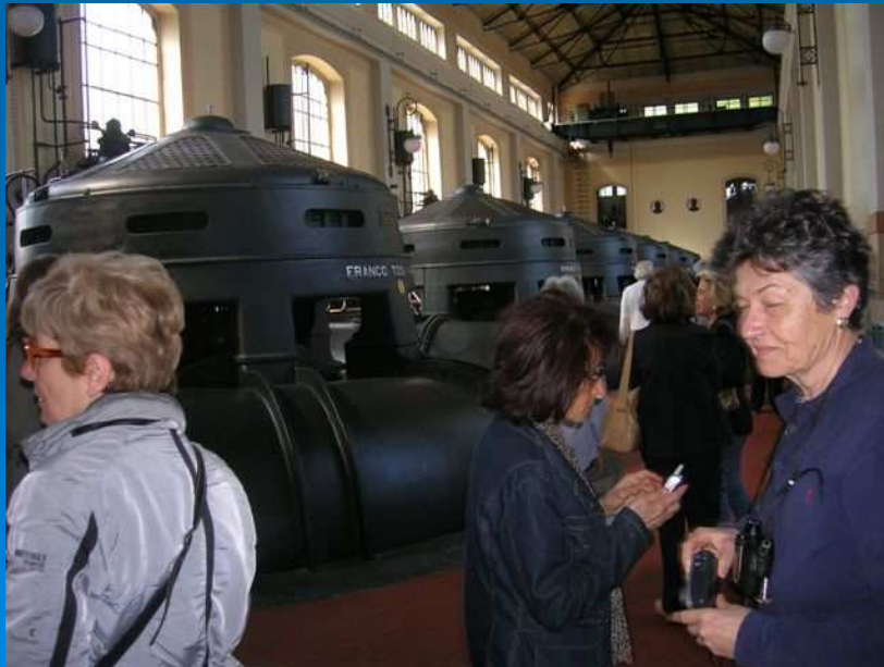
La sala pompe dell'impianto idrovo
